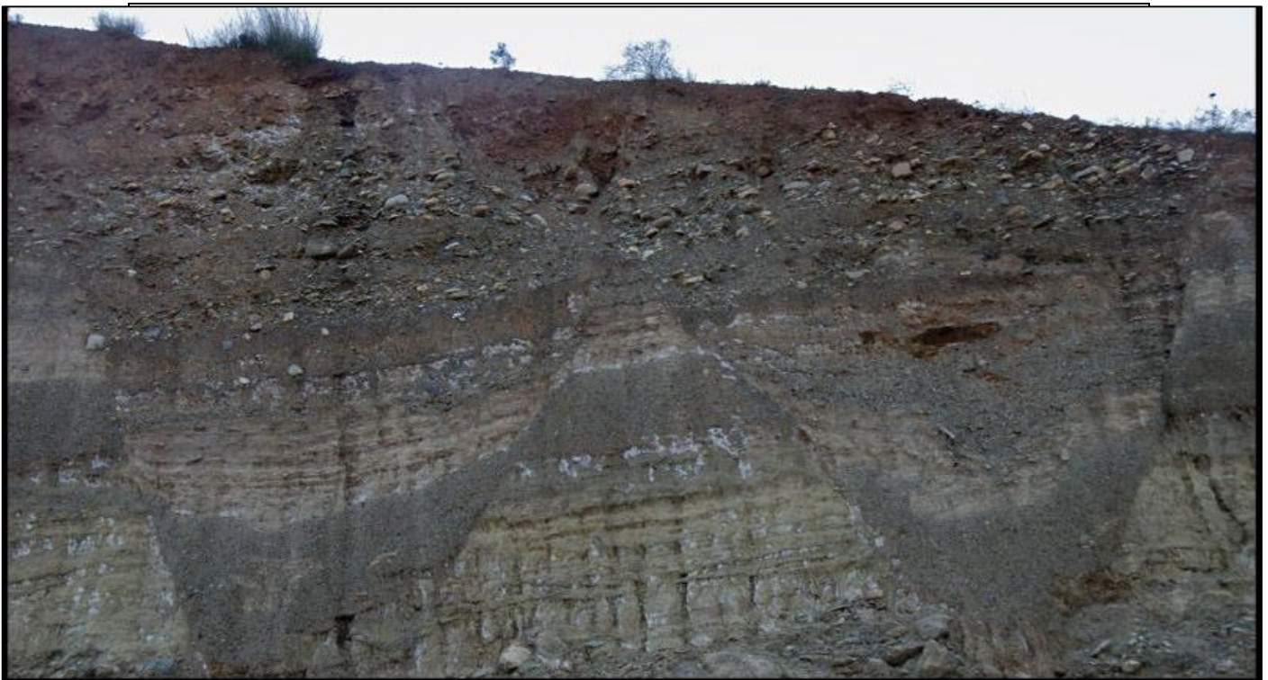
Fallas en Alhucemas (Marruecos) fosilizadas por materiales detríticos gruesos, sin manifestación geomorfológica
